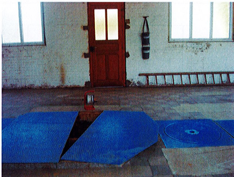
Photographie 2 : Tête du forage 00492X0001/F dans le local technique (source : Antea Group)
